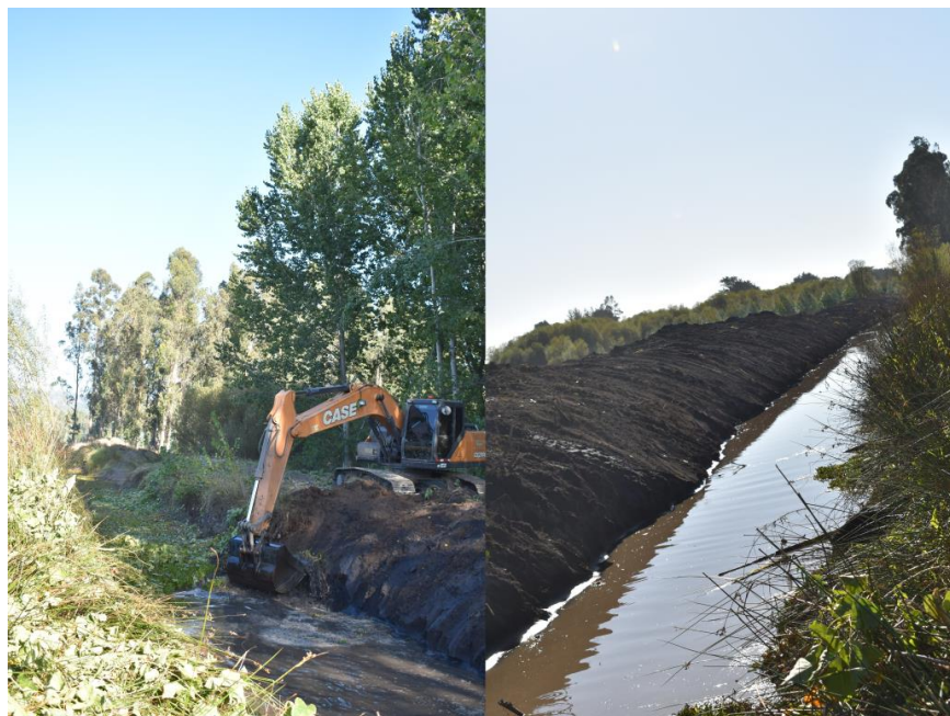
Figura 43. Registro de obras de ensanchamiento de canales en Humedal Calabozo, sector Agrícola del Sur (25 de marzo, 2022).
